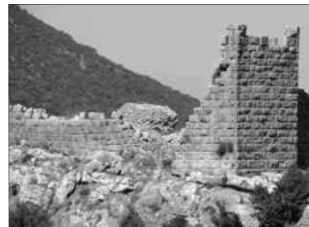
Εικ. 32. Ο ΒΑ πύργος του αρχαίου φρουρίου των Αιγιοσθένων πριν την έναρξη των εργασιών
