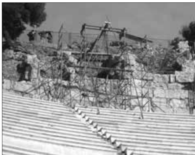
Εικ. 7. Ωδείο Ηρώδου Αττικού: Το τόξο του βόρειου περιμετρικού τοίχου που πρόκειται να αποκατασταθεί
