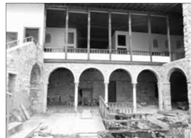
Εικ. 2. Αρχοντικό Μπενιζέλων. Άποψη της βόρειας αυλής κατά τη διάρκεια των εργασιών
