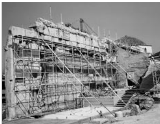
Η εσωτερική παρειά της βόρειας πτέρυγας της πρόσοψης της Βιβλιοθήκης Αδριανού το 2000.
