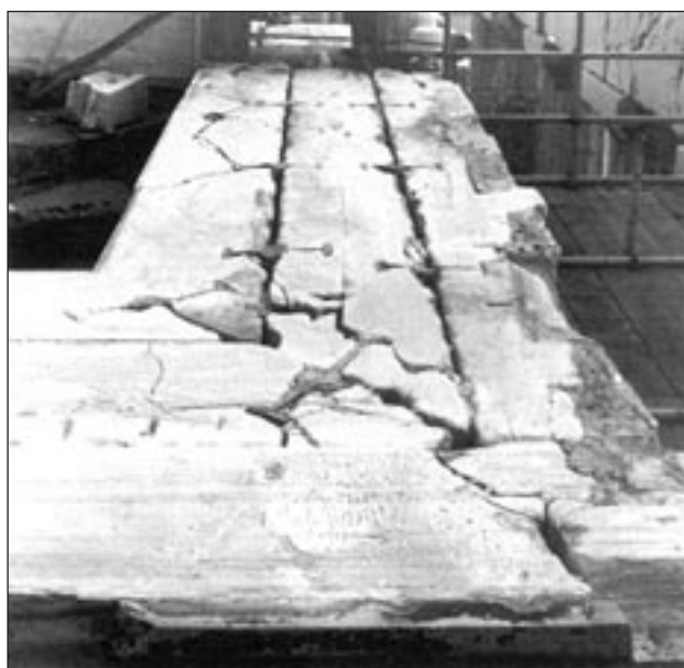
Οπισθόναος του Παρθενώνος. Η κατάσταση διατηρήσεως των επιστυλίων, όπως αποκαλύφθηκε με την απομάκρυνση της ζωφόρου (1993).
