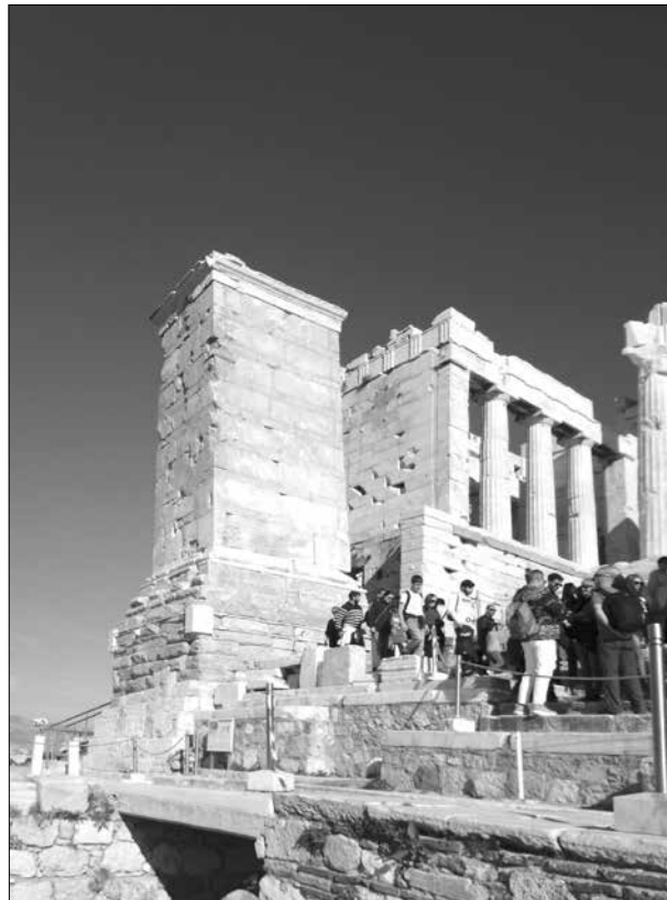
Πρόσφατες εργασίες συντήρησης και ενίσχυσης στο βάθρο του Αγρίππα με χρηματοδότηση από το ΕΣΠΑ 2014-2020. Φωτ. Β. Ελευθερίου, 2023
