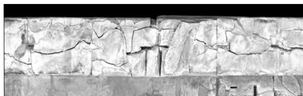
Εικ. 10. Κάτωση του 3ου δόμου του αντιθηματικού τοίχου μετά την αποξήλωσή του. Ορθοφωτομωσαϊκό Γραφείο Τοπογραφίσεων ΥΣΜΑ, 2019
