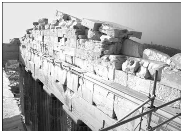
Εικ. 7. Ο αντιθηματικός τοίχος του δυτικού αετώματος πριν τις εργασίες. Φωτ. Ρ. Χριστοδουλοπούλου, 2005
