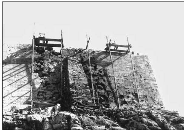
Εικ. 1. Εργασίες στερέωσης στη νοτιοανατολική γωνία των τειχών από τον Α. Ορλάνδο (1950)
